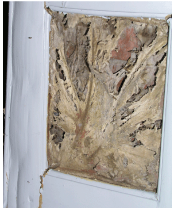
Kapitale Stränge vom Echten Hausschwamm im Durchmesser von Bleistiften hinter einer Holzkassettenwandbekleidung (die Füllung wurde abgenommen).
